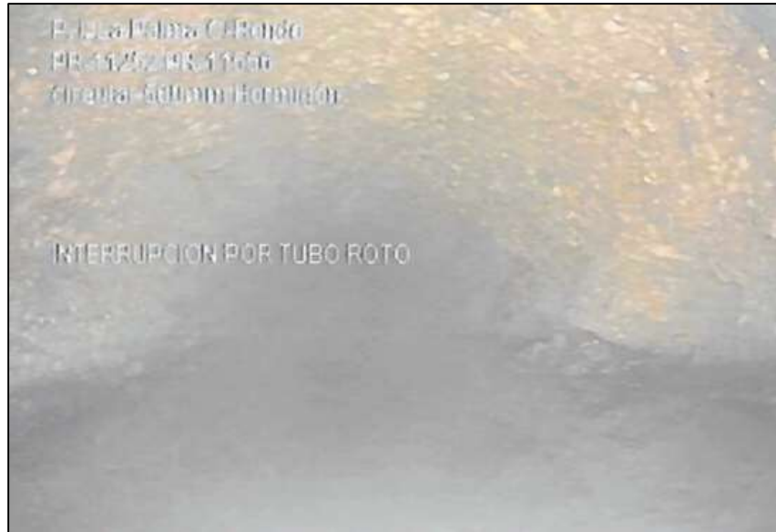
Figura 2. CCTV de la red de alcantarillado donde se observa la rotura del colector existente en la C/Rondo.
